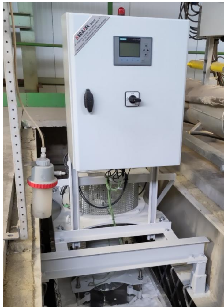
Einbaufoto in der Decke eines Ziegelofens
